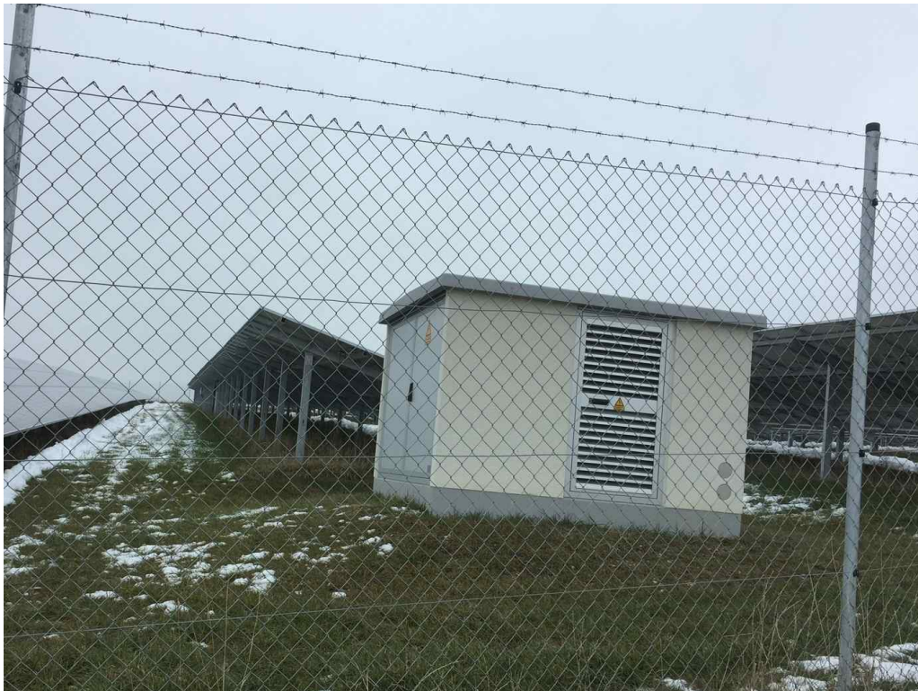
Trafostation einer gleichartigen Photovoltaik-Freiflächenanlage. Je 1 ha Anlage ist mit einer Trafostation zu rechnen. Der Trafo ist deutlich niedriger und schmaler als die Modultische .
